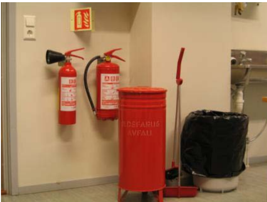
Figur 11 CO 2 -apparat (til venstre), pulverapparat og søppelkasse for brannfarlig avfall
